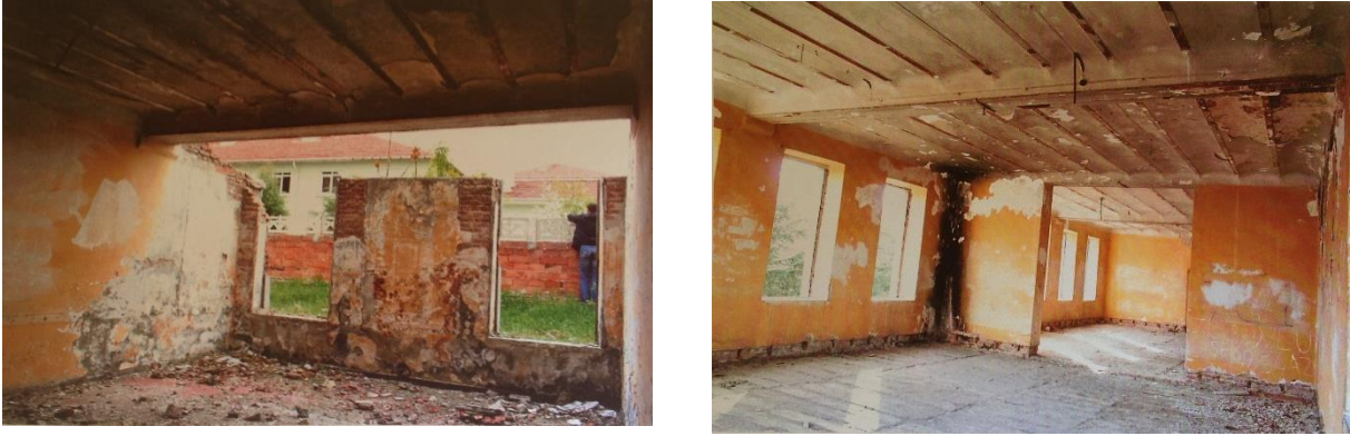
Şekil 9. Restorasyon öncesi B Kütlesi Zemin Kat ameliyathane olarak kullanılmış oda ve D Kütlesi 1. Kat kadın hasta koğuşu olarak kullanılmış salon (Mimar Ali Kamil Yalçın, 2006)
