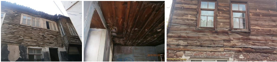
Şekil 18: Ahşapta doku bozulması(solda), mantar oluşumu(ortada), renk değişimi ve aşınma(sağda)
