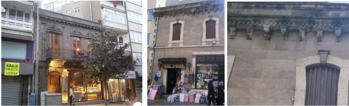
Şekil 15: Atmosferik kirleticiler nedeniyle taş yapı yüzeylerinde ve özellikle saçak altında oluşan kabuklar, lekeler ve aşınmalar
