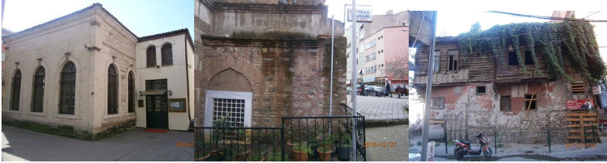
Şekil 17: Zemin suyu etkisi (solda), çatı sızıntı suyu etkisi (ortada), rüzgar veya kuş vb hayvan etkisiyle çatılarda bitki tohumlarının birikmesi neticesinde biyolojik oluşum(sağda)
