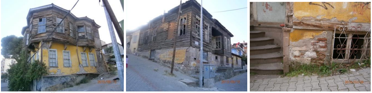
Şekil 13: Eğimli zemindeki yapılarda görülen bozulma örnekleri; biyolojik oluşum (solda), sıva harcında dökülme/aşınma(ortada), tuğla yüzeyinde çiçeklenme(sağda)
