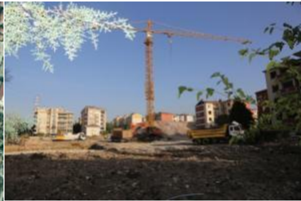
Şekil 13. Ataevler Mahallesi'nde Yıkım (Anonim 3, 2016)
