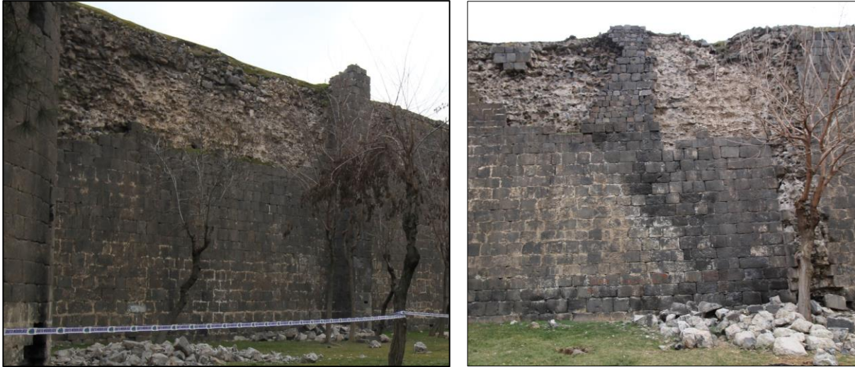
Foto 17: Burçlar arasındaki sur duvarlarında meydana gelen yıkılmalar
