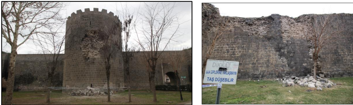
Foto 15: Burçlarda meydana gelen yıkılmalar
