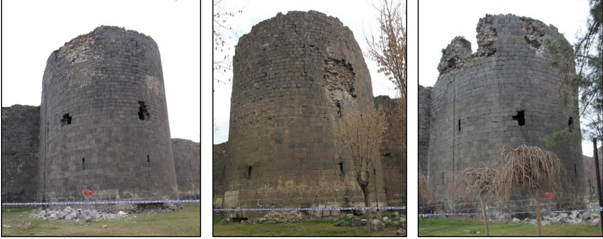
Foto 16: Farklı burçlarda meydana gelen yıkılmalar
