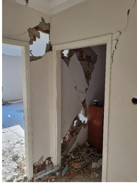
Şekil 7 Yapı İçlerinde Meydana Gelen Hasar (B. AYDIN, 2023)
