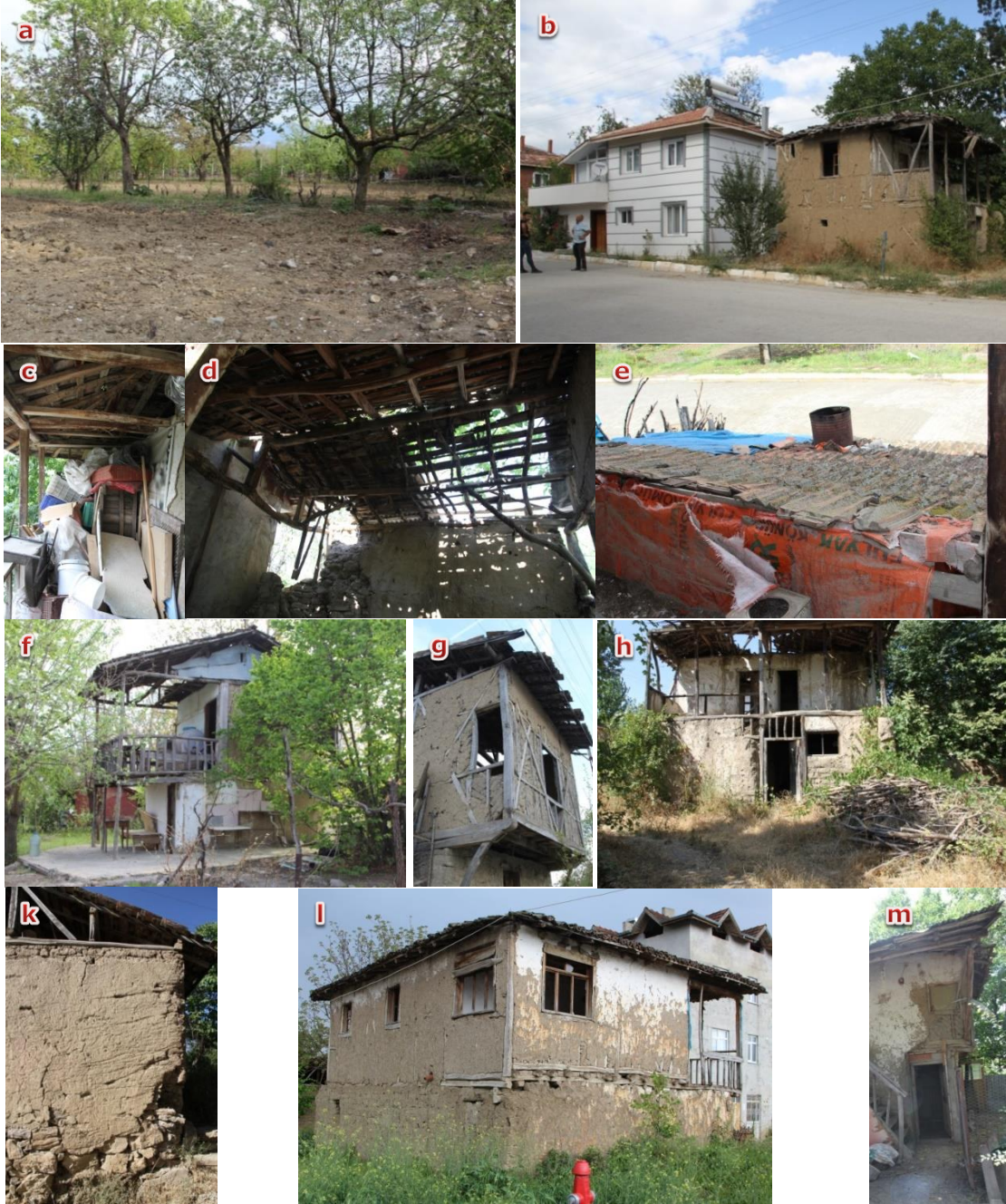
Şekil 23. Tokat bağ yerleşmelerindeki değişim ve bozulmalar
