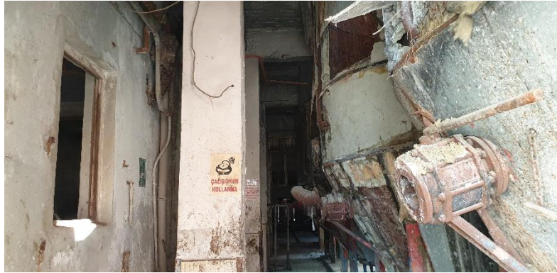
Şekil 11: Sabunhane binası iç mekanındaki kaynatma bölümü ve kaynatma kazanları (Yazar Arşivi, Ağustos, 2021)
