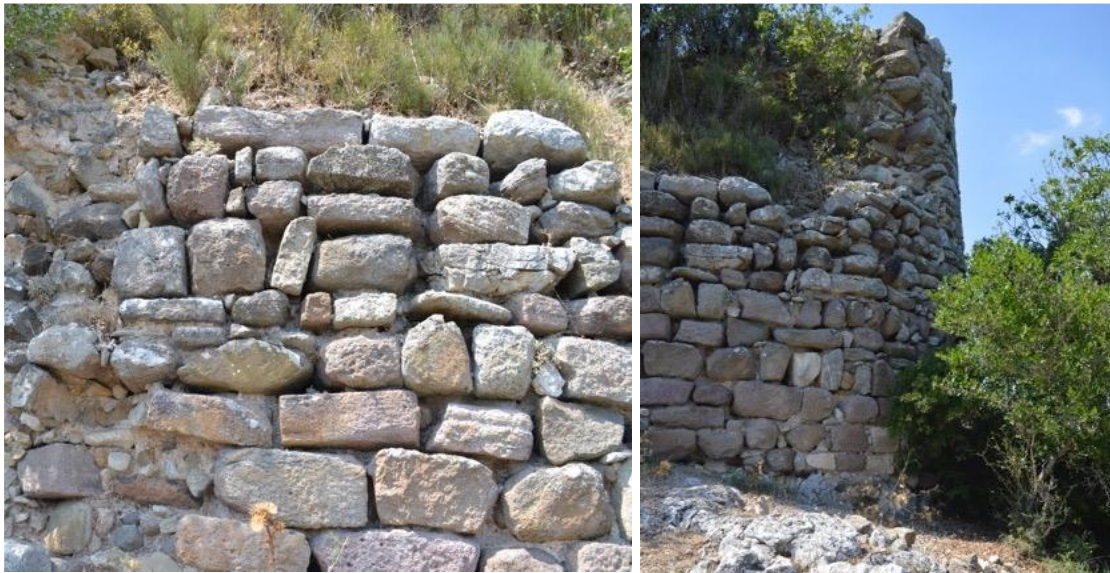
Şekil 14:Kuzeydeki 4 No.lu kule duvar örgüsünde derz boşalması
